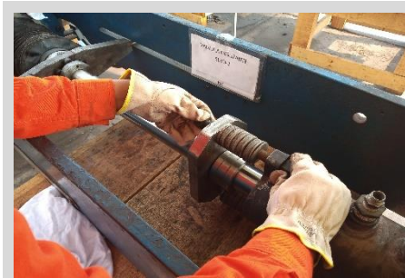
Válvula deslizante SLVD-2 de la Planta Catalítica
