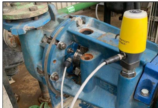
1510 instalado con monitor Chesterton Connect
